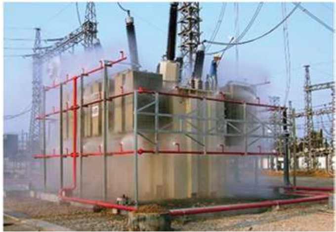
ภาพที่ ๓๓ การทำงานของระบบหัวกระจายน้ำดับเพลิงแบบเปิด เพื่อป้องกันเพลิงไหม้ของหม้อแปลงไฟฟ้าชนิดน้ำมัน
